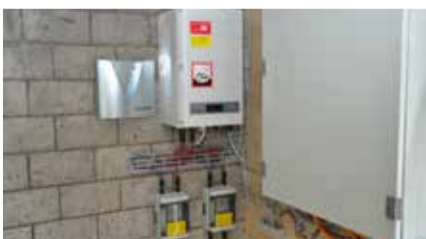
Wechselrichter PV-Anlage (links) und der Haushaltsstrom-Kasten.
